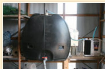
Super 501 installed in the workshop next to the water storage tank. 貯水タンクを付設した作業所内のスーパー501
